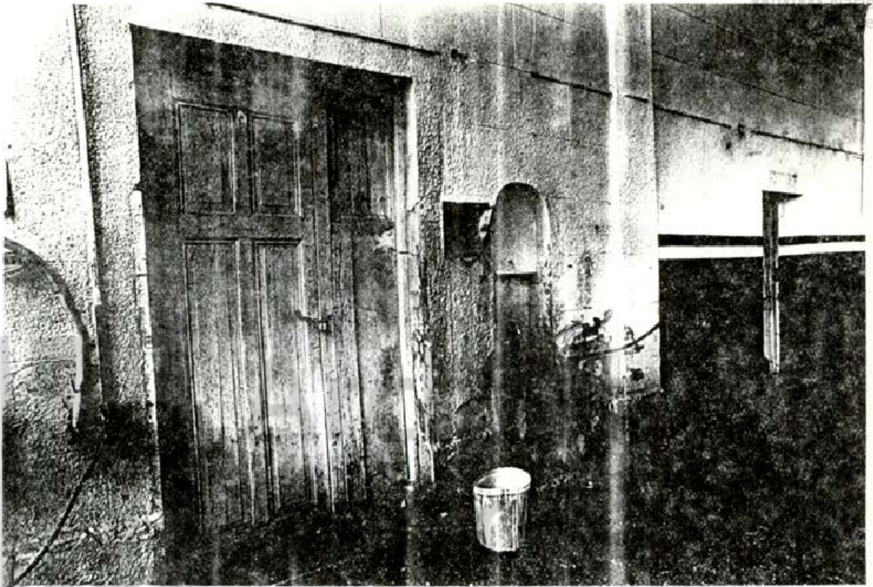
PUERTA DE ACCESO A LA HABITACION QUE CONTIENE LAS BOMBAS - DECLARADO POR LOS TESTIGOS ANTES DE SER ABIERTA.
